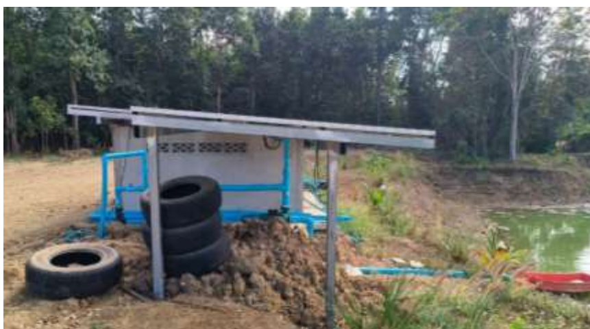
ภาพที่ 2 การสูบน้ำ โดยใช้โซลาร์เซลล์ (Solar Cell)
