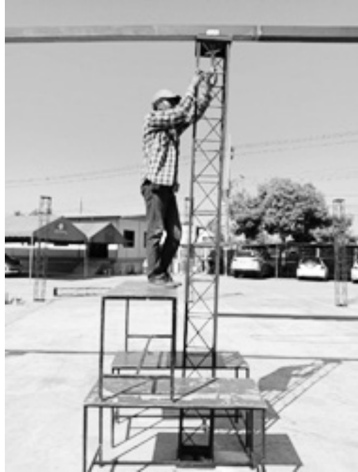
ภาพที่ 5 ประกอบเข้ากับเสาและคานรับหลังคา
