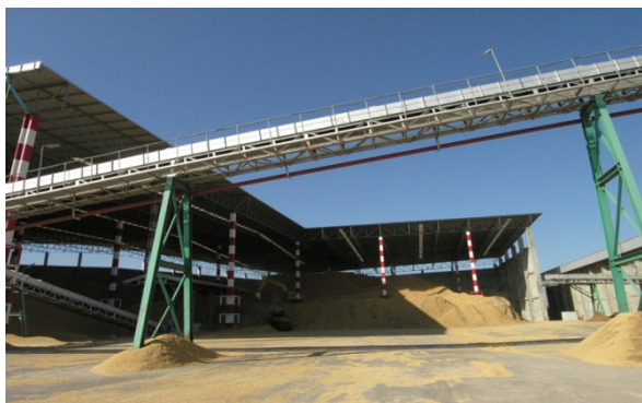
รูปที่ 1 โรงไฟฟ้าชีวมวลร้อยเอ็ดกรีน จังหวัดร้อยเอ็ด
