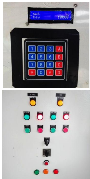
รูปที่ 7 แผงควบคุม หน้าจอแสดงผล และตู้ควบคุม ปั้มน้สูบกากน้ำตาลที่ทำงานร่วมกัน
