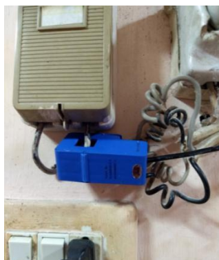
ภาพที่ 9 การใช้งาน CT เช็กระแสไฟฟ้า
