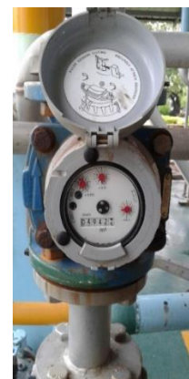
รูปที่ 16 Water Flow Meter
