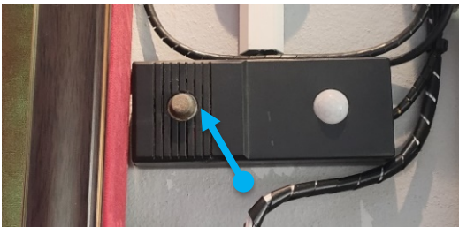
รูปที่ 12 อุปกรณ์ตรวจจับควัน
