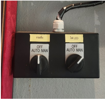
รูปที่ 15 สวิตช์ควบคุมการทำงาน
